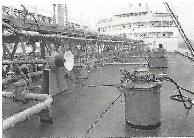
„Meco” ventilator gemonteerd op de „Butterworth” opening.
